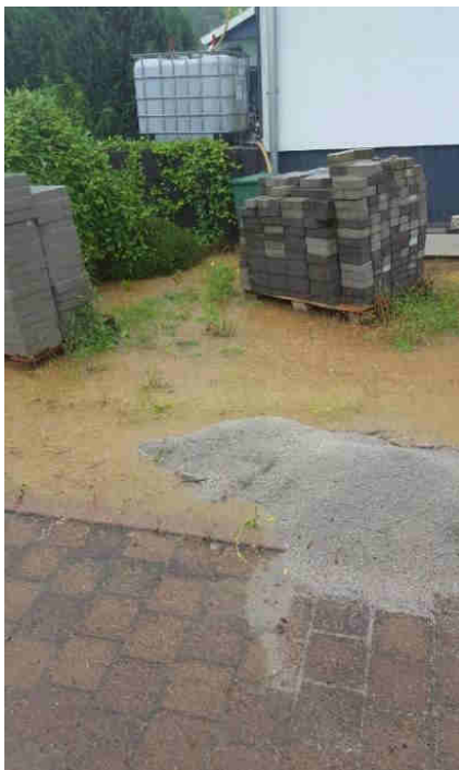
Abbildung 48: Überflutung Außenanlage Haus Nr.3
