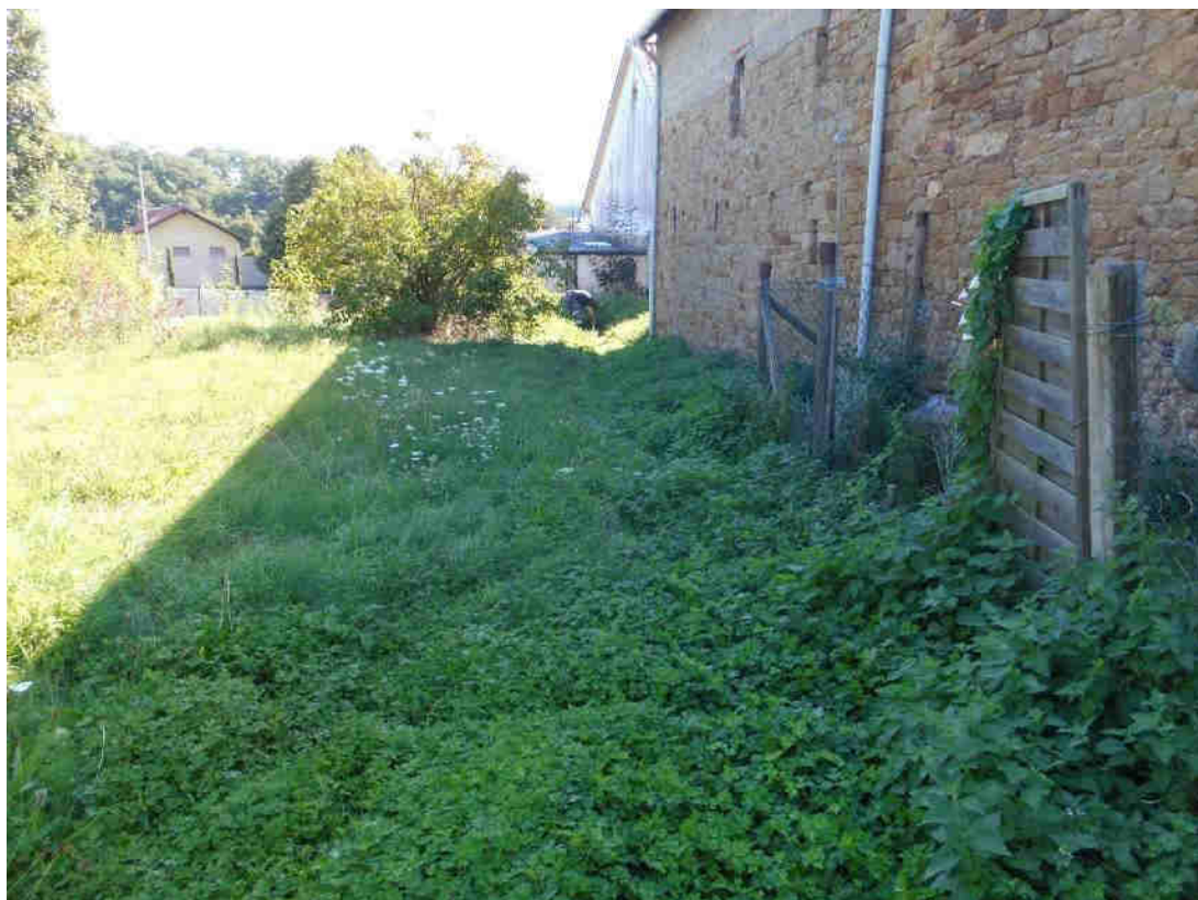
Abbildung 41 : Tiefpunkt „Am Trog“ mit unklarer Wasserführung
