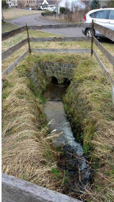
Abbildung 13: Durchlass 2x DN 300
