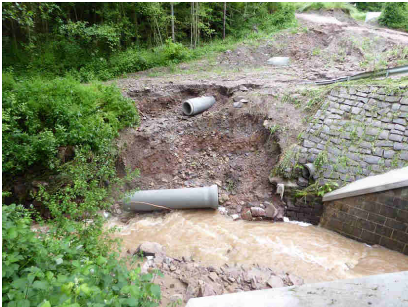
Abbildung 14: Verbindungsrohre RRB 10:44 Uhr, 30.05.2016 [6]
