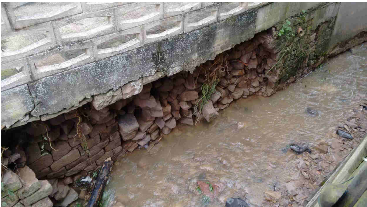
Abbildung 20: Weggespülte Mauer unter Grundstück Fürfelder Str. 7:30 Uhr [6]
