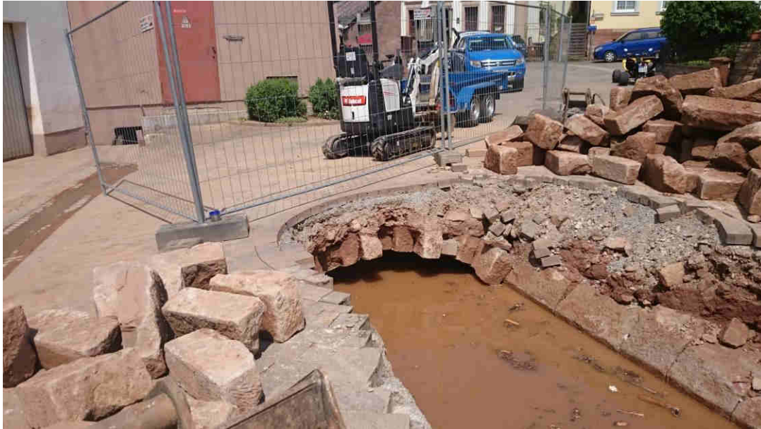
Abbildung 17: Aufgerissener Durchlass Kanalstraße (Blick in Fließrichtung), 07.06.16 [8]
