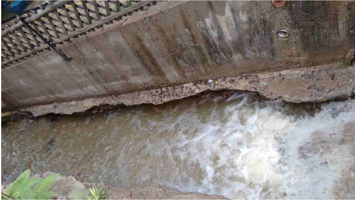
Abbildung 21: Unterspülte Mauer Fürfelder Str. 7:26 Uhr, 31.05.2016 [6]
