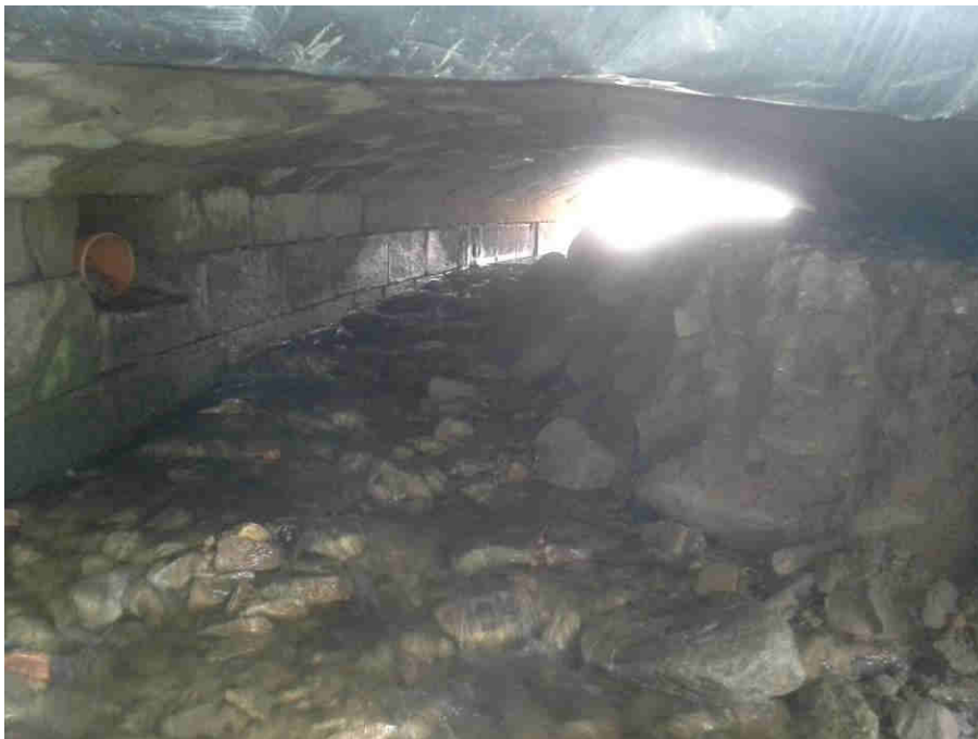
Abbildung 18: Geröllablagerungen unter Brückendurchlass (Blick gegen Fließrichtung), 26.06.2016 [8]
